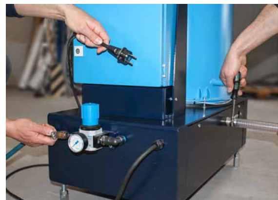
Tilslutninger, komprimeret luft, el og fodringsledning
